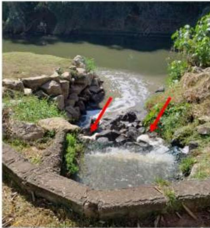
Foto 12 – Lançamento do efluente da ETE Itanguá
