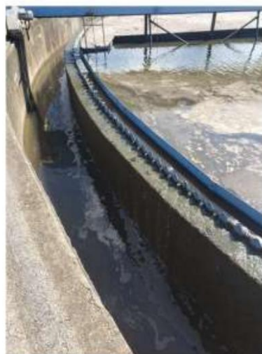
Foto 13 – Decantador secundário com presença de sobrenadante, inclusive no líquido que verte do equipamento
